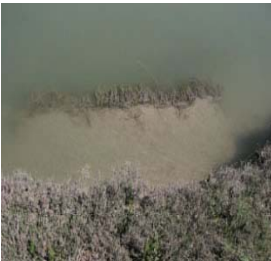
Figura 1.1 - Esempio dell'azione erosiva
